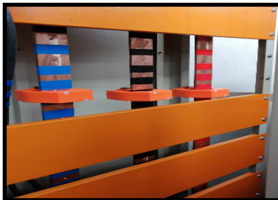
Figura 14. Montaje de los transformadores de corriente TC en las barras de distribución de cobre 800 A.
